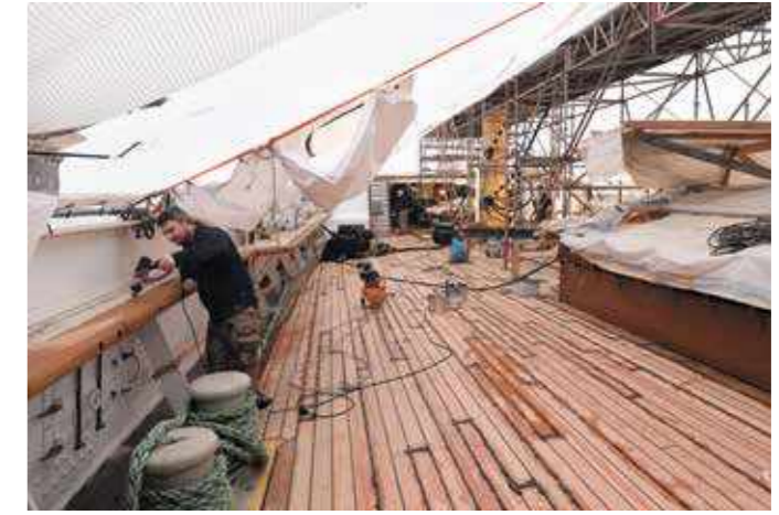
Das Hauptdeck musste komplett erneuert werden. Auf eine Lage Kork verlegten die Schiffsbauer Planken aus Oregon Pine.
