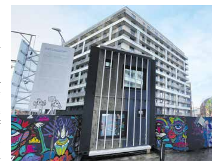
Ein Beispiel-Element der zukünftigen Fassade steht vor der Baustelle des Viva-con-Agua-Hotels. © MATTHIAS SCHINCK
