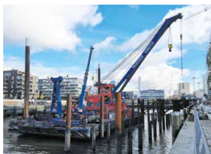
Der Schwimmkran von Taucher Knoth hat einen Hauptthub von maximal 110 Tonnen, einen Hilfsthub mit 25 bis 30 Meter Ausladung und einen zweiten mit 12,5 bis 30 Meter Ausladung.
