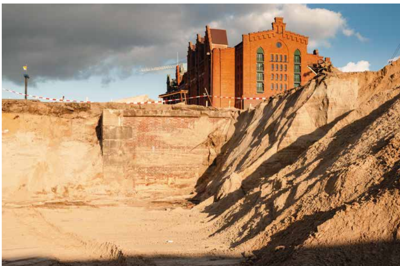
Im Oktober 2007 wird in der Baugrube des Überseequartiers für einen Moment die kaiserzeitliche Kaimauer des Sandtorhafens wieder sichtbar, dessen Hafenkopf schon in den 80er-Jahren des vorigen Jahrtausends für die Schuppen der Kaffeelagerei zugeschüttet worden war. © THOMAS HAMPEL
