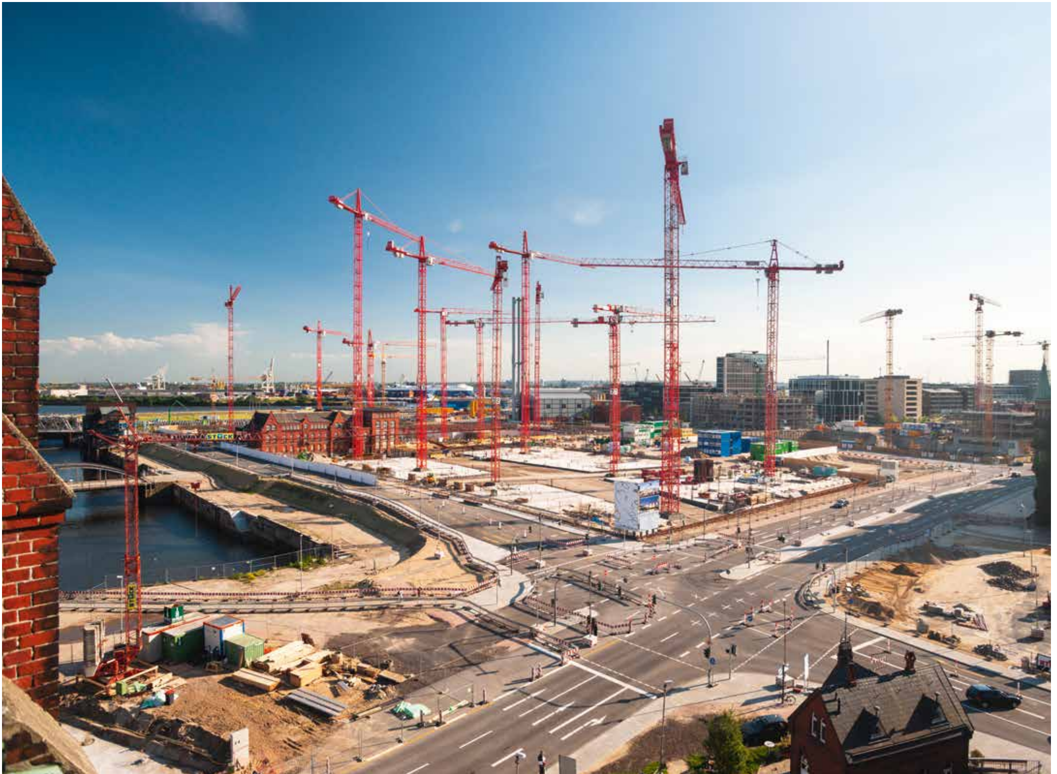
Freier Blick zur Elbe: Die Kreuzung Brooktorkai/Am Sandtorkai, Bei St. Annen/Brooktor (heute: Osakaallee), dahinter die noch nicht weit aus dem sandigen Boden gewachsene Baustelle des nördlichen Überseequartiers im Juli 2008. Der Wald der roten Kräne bestimmt für Jahre das Bild der zentralen Hafencity. © THOMAS HAMPEL
